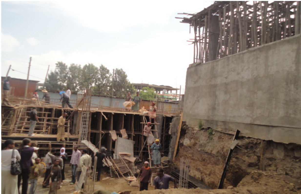
ፎቶ 6 በሻሸመኔ ከተማ ቤኬራ የንግድ ማዕከል በግንባታ ወቅት ከወለል በታች ባለ ቁፋሮ በአጎራባቹ ያለውን G+2 ህንጻ ስጋት ላይ ጥሎት
