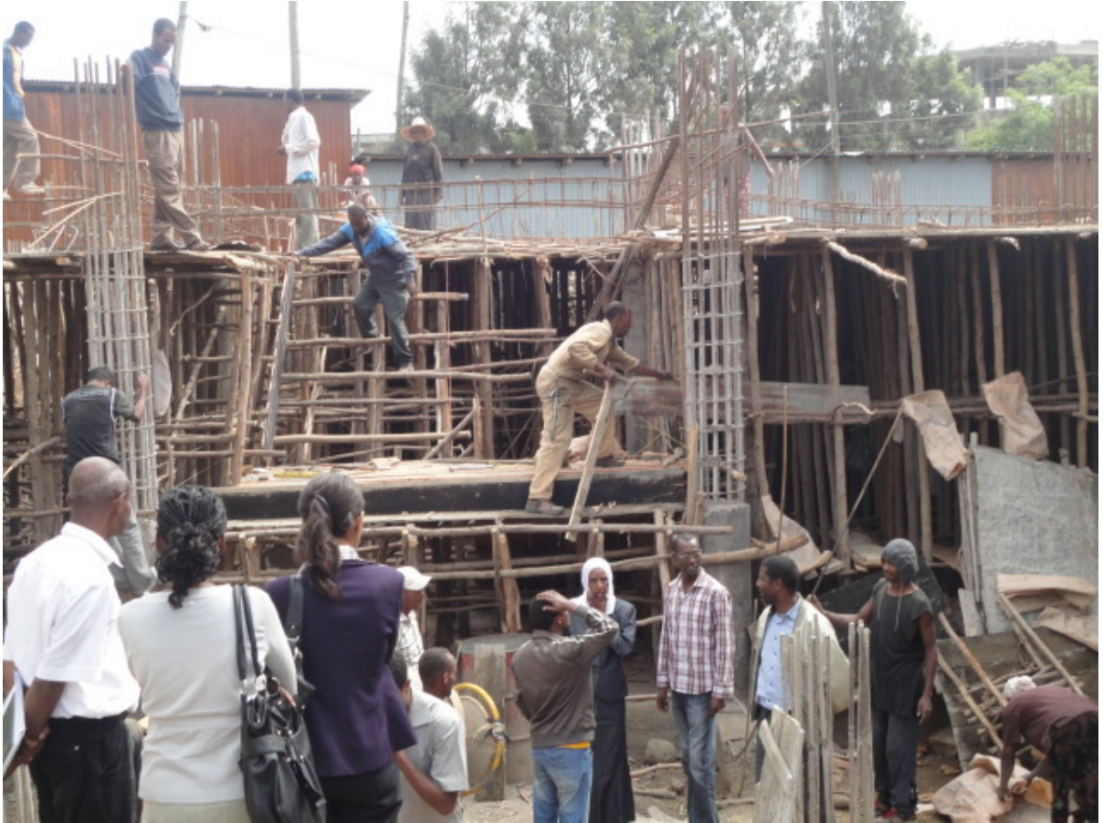
ፎቶ 7 የደህንነት መጠበቂያ የማይጠቀሙ የግንባታ ሠራተኞች
