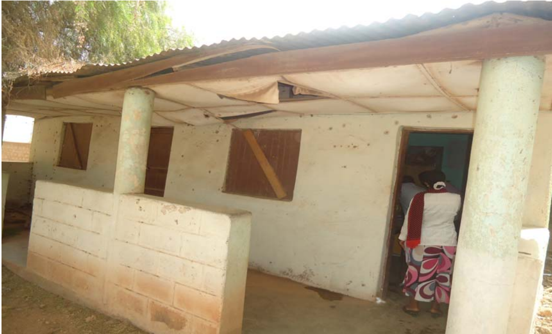
ፎቶ:- 5 በሱማሌ ክልል ቀብሪበያ ወረዳ የእንስሳት ክሊኒክ መድሃኒት ቤት ፈራርሶና በክረምት ወራት ዝናብ ሊያስገባ የሚችል መሆኑን የሚያሳይ።
