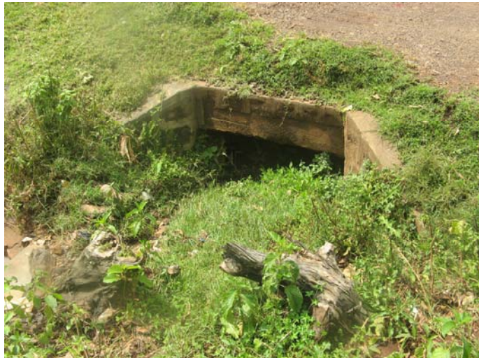
ፎቶ 4፤ የፍላሽ ማስወገጃያ ቦዮች ተገቢው ክትትል ስላልተደረገላቸው ተደፈኑበት ሁኔታ
