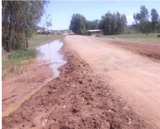
ፎቶ 11፤ ባ/ዳር - አዴት መስመር በአግባቡ የፍላሽ ማውረጃ ባለመዘጋጀቱ ፍላሽ መንገዱን ያበላሽበት ሁኔታ
