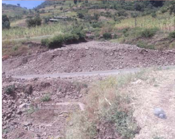
ፎቶ 12፤ በድሬደዋ መስመር የፍላሽ ማስወገጃያ ሦሮች አስፈላጊው እንክብካቤ ስላልተደረገላቸው በአፈር ተደፍነው አፈሩ በመንገዱ ላይ የፈሰሰበት ሁኔታ
