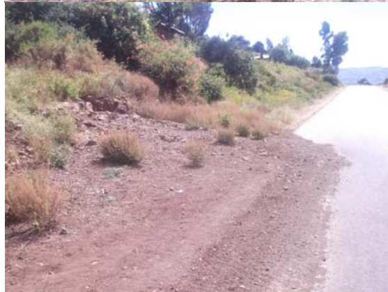
ፎቶ 13፤ በድሬደዋ መስመር የፍላሽ ማስወገጃያ ሦሮች አስፈላጊው እንክብካቤ ስላልተደረገላቸው በአፈር ተደፍነው አፈሩ በመንገዱ ላይ የፈሰሰበት ሁኔታ
