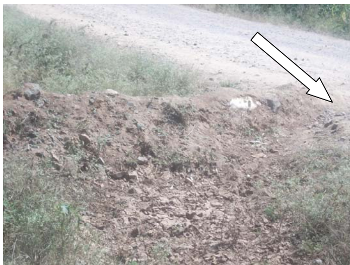
ፎቶ 5፤ በድሬዳዋ ዲስትሪክት በአደሌ ግራዋ መንገድ ላይ ኅብረተሰቡ የመስኖ ውኃ ለማስተላለፍ መንገዱን በተለያዩ ቦታዎች ላይ በዚህ መልክ የሚሰነጥቅበት ሁኔታ ይታያል፤
