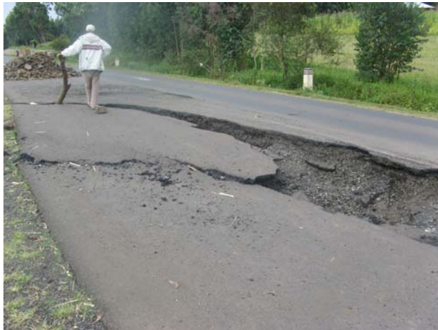
ፎቶ 1፤ በደብረማርቆስ ዲስትሪክት ወይንማ መንደር በመሬት መንሸራተት ምክንያት የተበላሸው መንገድ ተገቢው ወቅታዊ ጥገና ያልተደረገበት ሁኔታ
