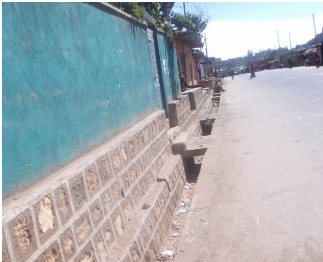
ፎቶ 6-7፤ በአዲስ አበባ ድሬዳዋ መንገድ በሂርና ከተማ የመንገዶች ዳር እና ዳር ይዞታዎች (right off way) ያልተከበሩበት እና እስከ ዋናው መንገድ ጠርብ ድረስ ግንባታዎች የተገነቡበት ሁኔታን የሚያሳይ፤
