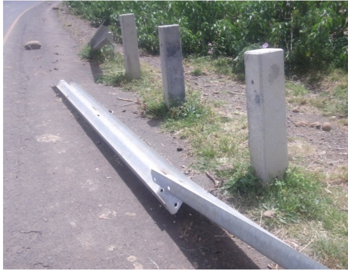
ፎቶ 3፤ በመተማ መስመር ስርቆት የተፈጸመበት የመንገድ ዳር መከላከያ።
