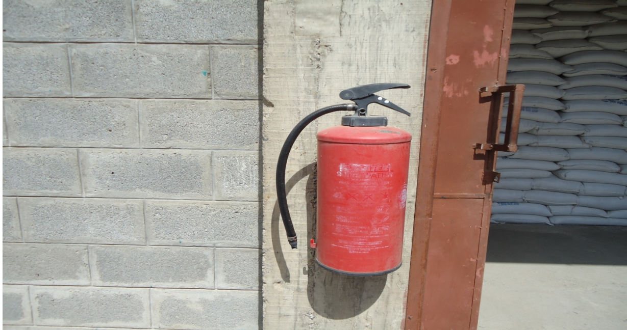
ፎቶግራፍ 4 ኮምቦልቻ ቅርንጫፍ ጽሕፈት ቤት የተበላሽ የእሳት አደጋ መከላከያ
