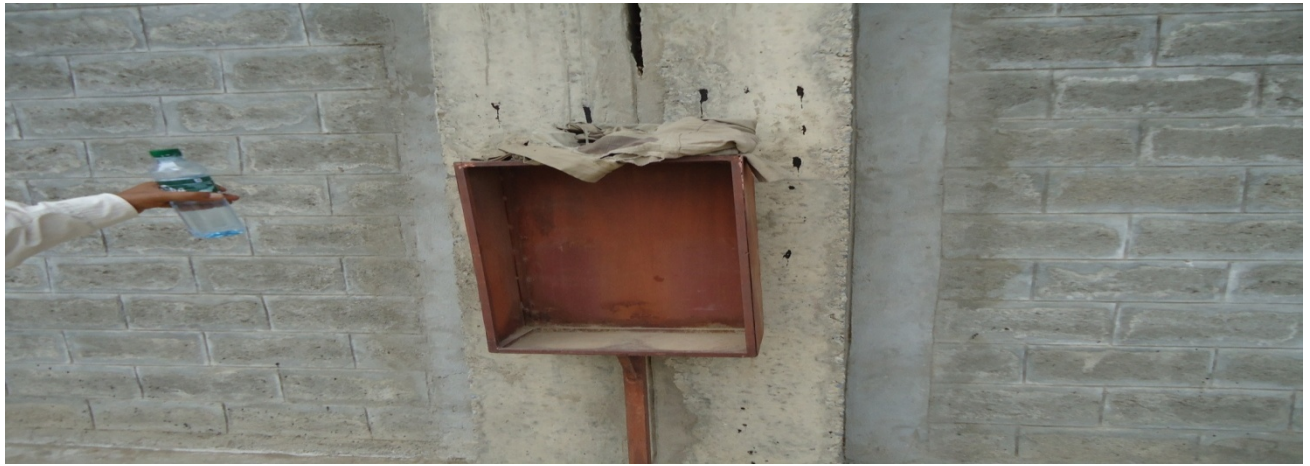
ፎቶግራፍ 5 በመቀሌ ቅርንጫፍ ጽሕፈት ቤት የእሳት አደጋ መከላከያ የሌለው መጋዘን
