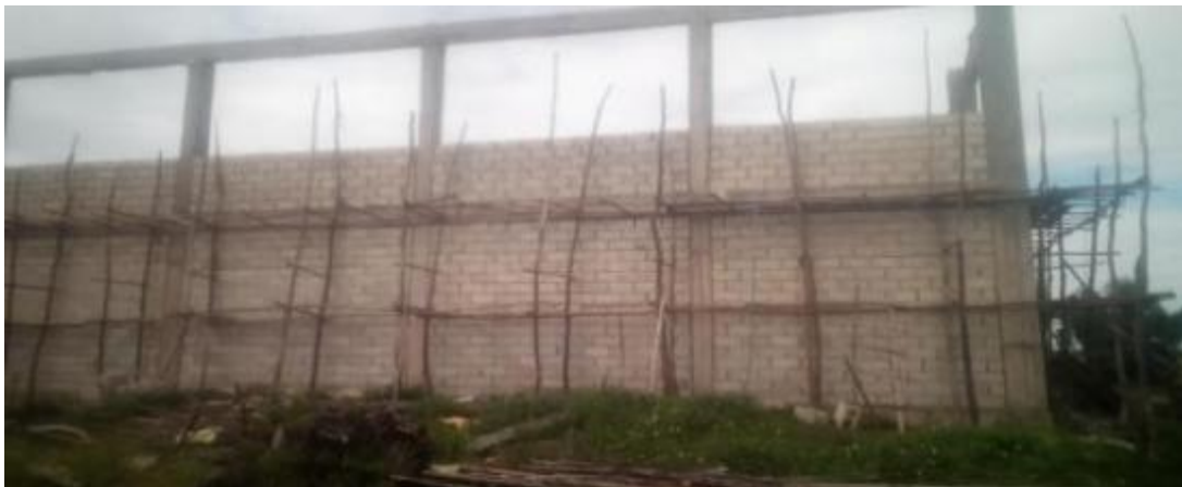
ምስል 5. ግንባታው ተጀምሮ ያልተጠናቀቀው የበሻ ወሊሶ የምጥን ማዳበሪያ ፋብሪካ መጋዘን ግንባታ
