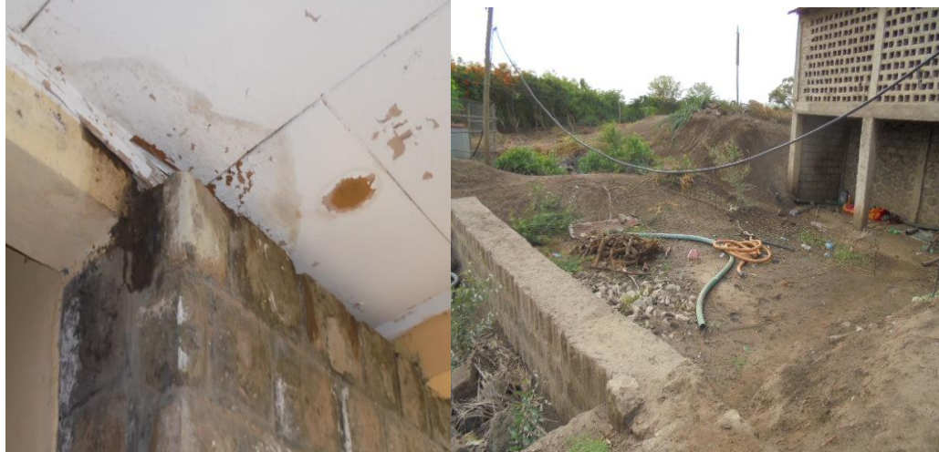
ፎቶ ቁጥር አንድ በፌዴራል ግብርና ምርምር ኢንስቲትዩት በወረር ማዕከል አገልግሎት ሳይሰጡ ለሌላ ችግር እየተጋለጡ የሚገኙ የቤት እና የፓንፕ ሳይት ግንባታዎች፤
