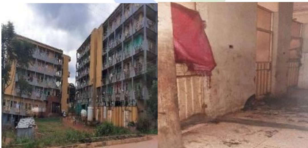
ፎቶ ቁ.2. ሐረር (ሐማሬሳ) የተፈናቃዮች መጠለያ ጣቢያ በውሃ እጦት ምክንያት ህንፃው ለብልሽት የተጋለጠና ሽንት ቤቶቹም በብልሽት አገልግሎት የማይሰጡ መሆናቸውን የሚያሳይ
