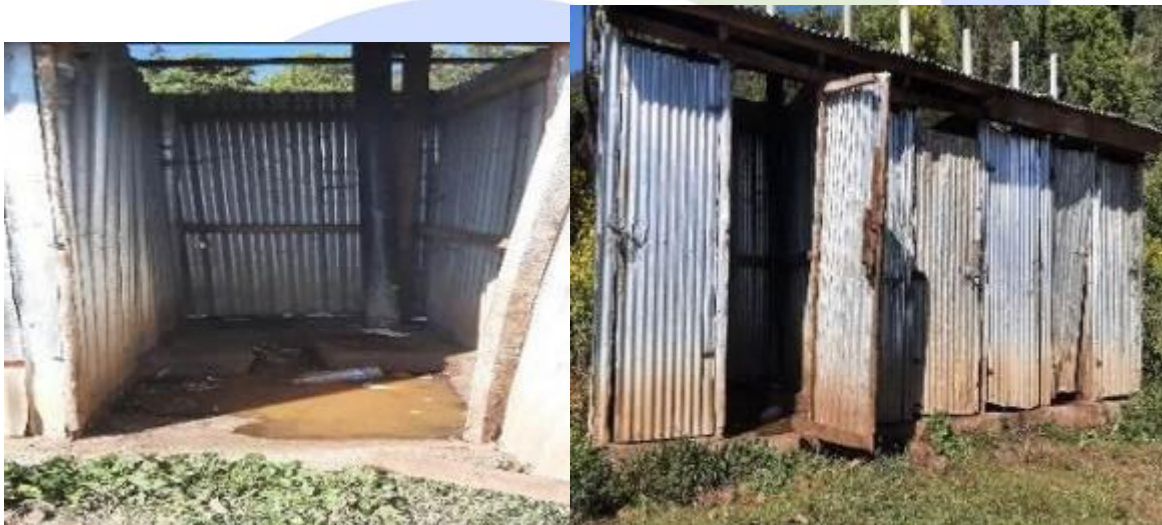
ፎቶ ቁ.4. በአሮሚያ ምስራቅ ሐረርጌ ዞን ደደር ወረዳ አልድ ጎልማሳ መጠለያ ጣቢያ የሚገኘው መጻዳጃ ቤት ተበላሽቶ አገልግሎት የማይሰጥ መሆኑን የሚያሳይ
