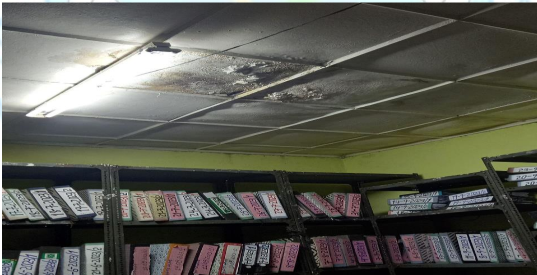
ፎቶ 8 በዋና መ/ቤት ጣሪያው የሚያፈስ መረጃ ማደራጃ ክፍል
