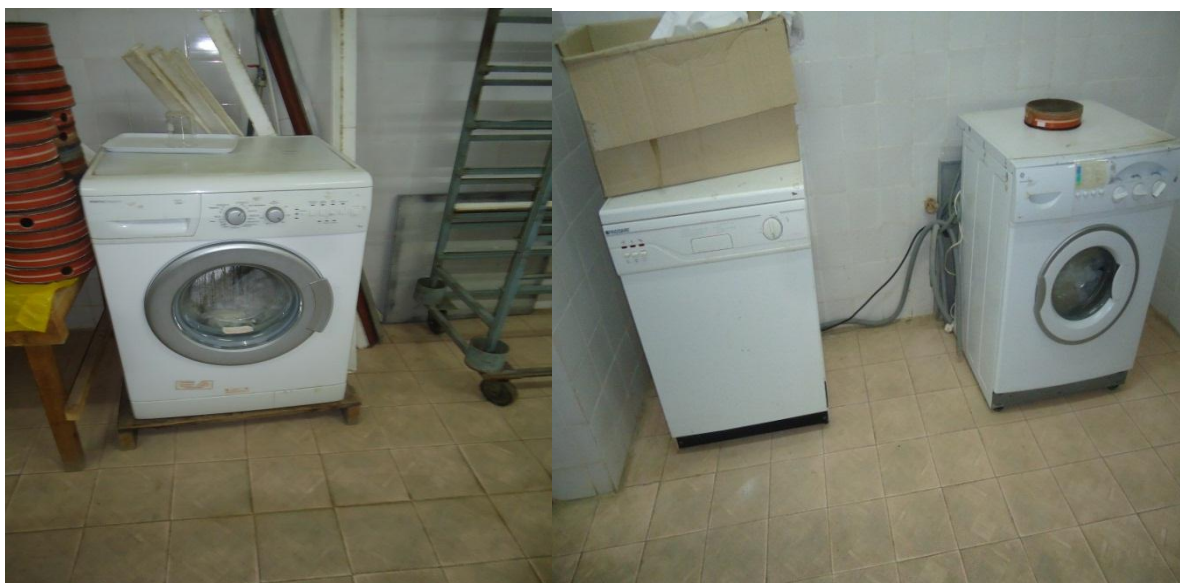
ፎቶ:- 4 በእርባታ ማዕከሉ ውስጥ ተበላሽተው አገልግሎት የማይሰጡ የማጠቢያ ማሸኖች የሚያሳይ
