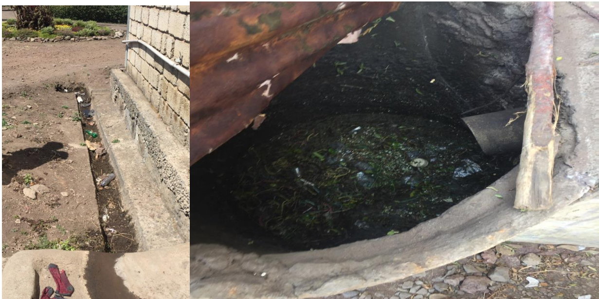
ፎቶ-7 በማከሚያ ቴክኖሎጂዎች (soak away pit) ውስጥ (ፕላስቲክ፣ ተረፈ ምርት፣ ፈሳሽ ቆሻሻ አንድ ላይ የሚጠራቀምበት መሆኑ እና ፈሳሹ የሚመጣበት ክፍት ቦይ)
